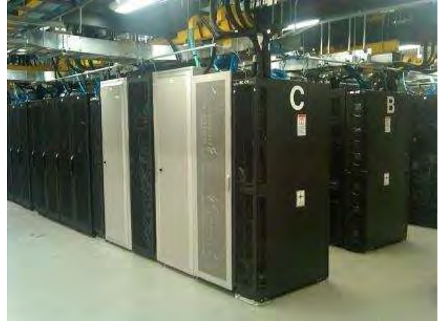
OIT Data Center in 2015 - Actual
